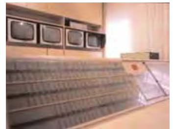
Wachzentrale mit Kontrollmonitoren
