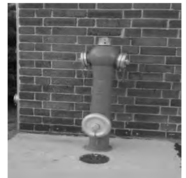
Ausbau des Feuerlöschsystems auf dem gesamten Gelände der Gedenkstätte.
