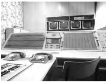
Wachzentrale mit Kontrollmonitoren
