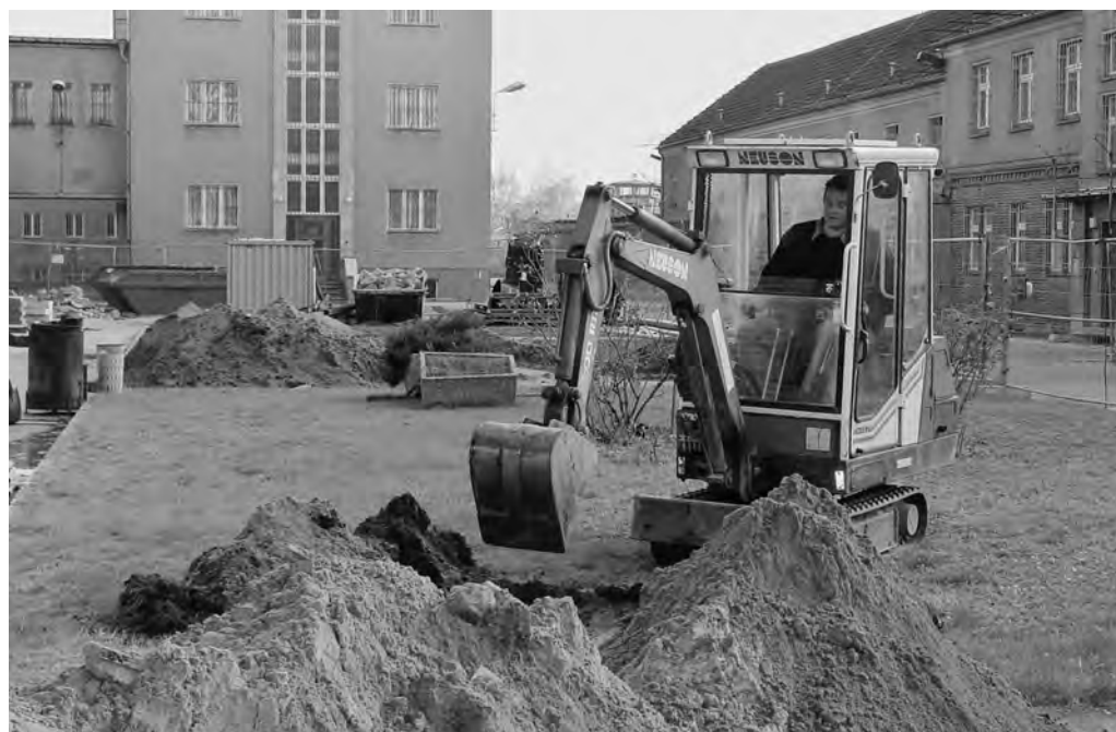
Erdarbeiten im Hof der Gedenkstätte; rechts im Hintergrund: das stark sanierungsbedürftige ehemalige Haftkrankenhaus
